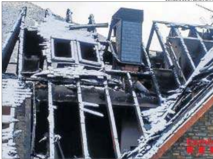
Els bombers van revisar ahir l'estructura dels edificis.
